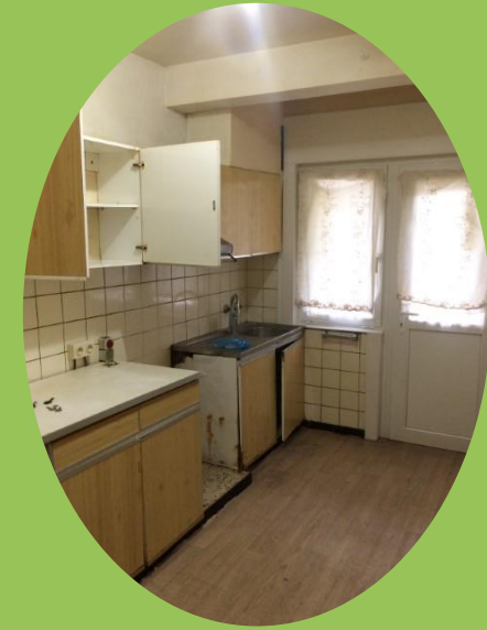
Uitgeleefde te renoveren panden woonmaatschappi j
